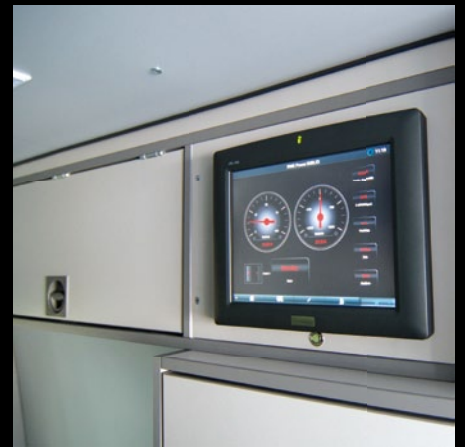
Touchscreen als Schalt- und Überwachungszentrale in einem Strahlenmessfahrzeug
