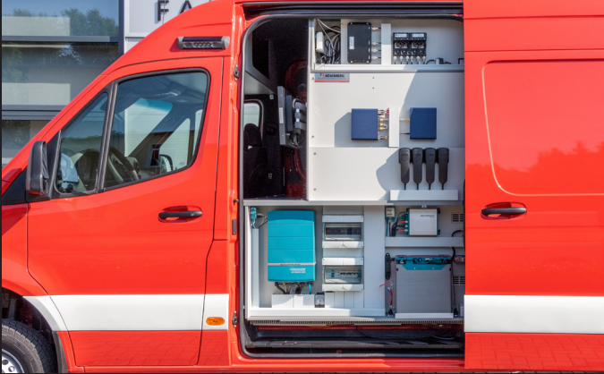
Zweite Schiebetür zum Technikraum.
