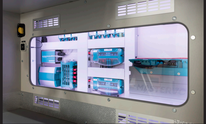
Zuverlässige Energieversorgung dank Mastervolt Lithium-Ionen-Batterie.
