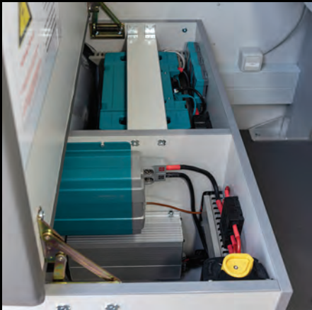
Stromversorgungssystem mit Lithium-Ionen Batterie und Bussystem.
