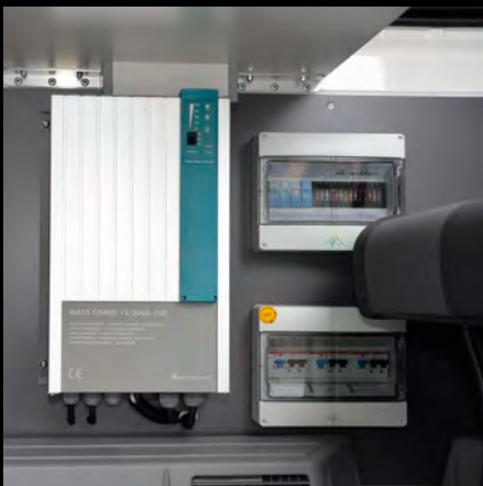
Stromversorgung und Absicherung leicht erreichbar unter dem Arbeitstisch montiert
